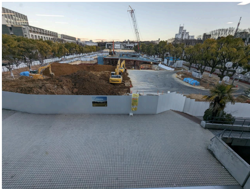
中央図書館3Fから撮影した第二グリーンベルトの工事の様子。中央奥に第1グリーンベルトと豊田講堂が見える。2024年1月26日撮影。
